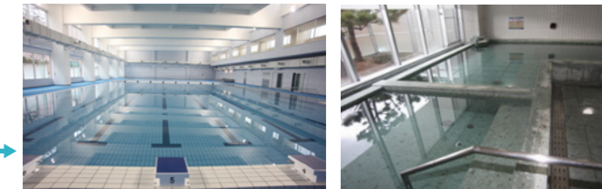
健康づくりセンター 熱エネルギーを回収して温水発生器でつくられた温水が、場外の健康づくりセンターの風呂やプールなどで利用されます。
