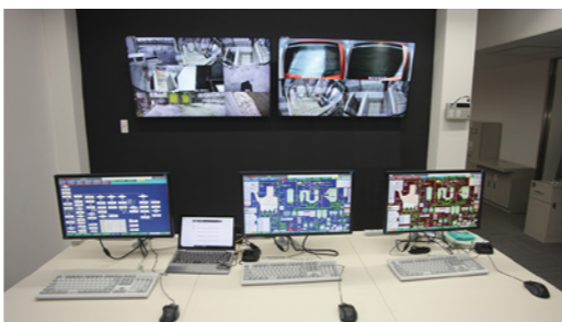
中央制御室 炉室に配置された焼却炉や、集じん器などの排ガス処理装置は、中央制御室のコンピュータにより制御され、ごみの完全燃焼や排ガスの状態を監視します。
