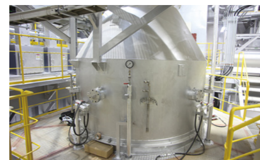
⑧ガス冷却室 ごみを燃やすと、高温の排ガスが発生します。排ガスは、ガス冷却室で水を噴霧され、冷やされます。その後の熱は、空気予熱器にて焼却炉燃焼用空気と熱交換しています。
