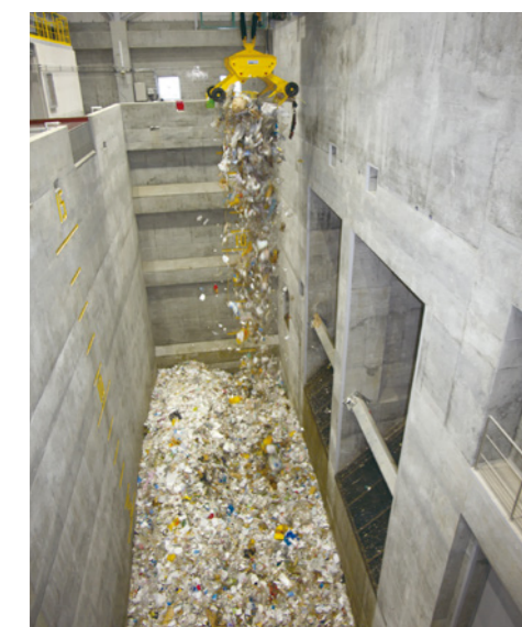
⑤ごみピット およそ深さ9m×幅21m×奥行7mで、1,300立方メートルのごみを貯めることができます。
