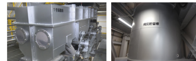
⑪煙突 処理された排ガスは、2本の内筒を通して地上50mの煙突から大気へ排出されます。
